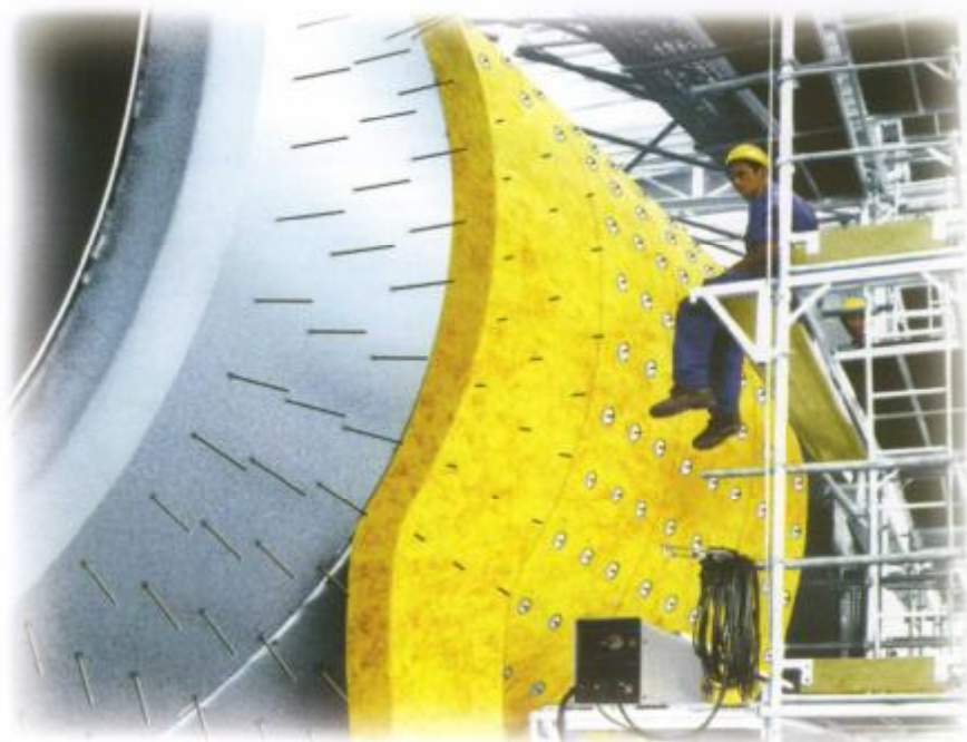
Рис. 48. Пример крепления теплоизоляции при помощи изоляционных шпилек на поверхности корпуса аппарата большого диаметра
